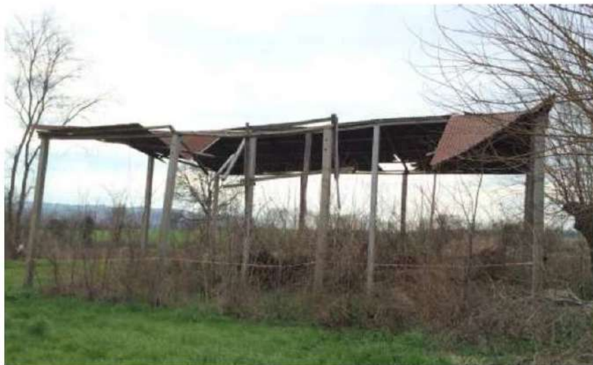
Vista accessorio pericolante e parzialmente crollato
